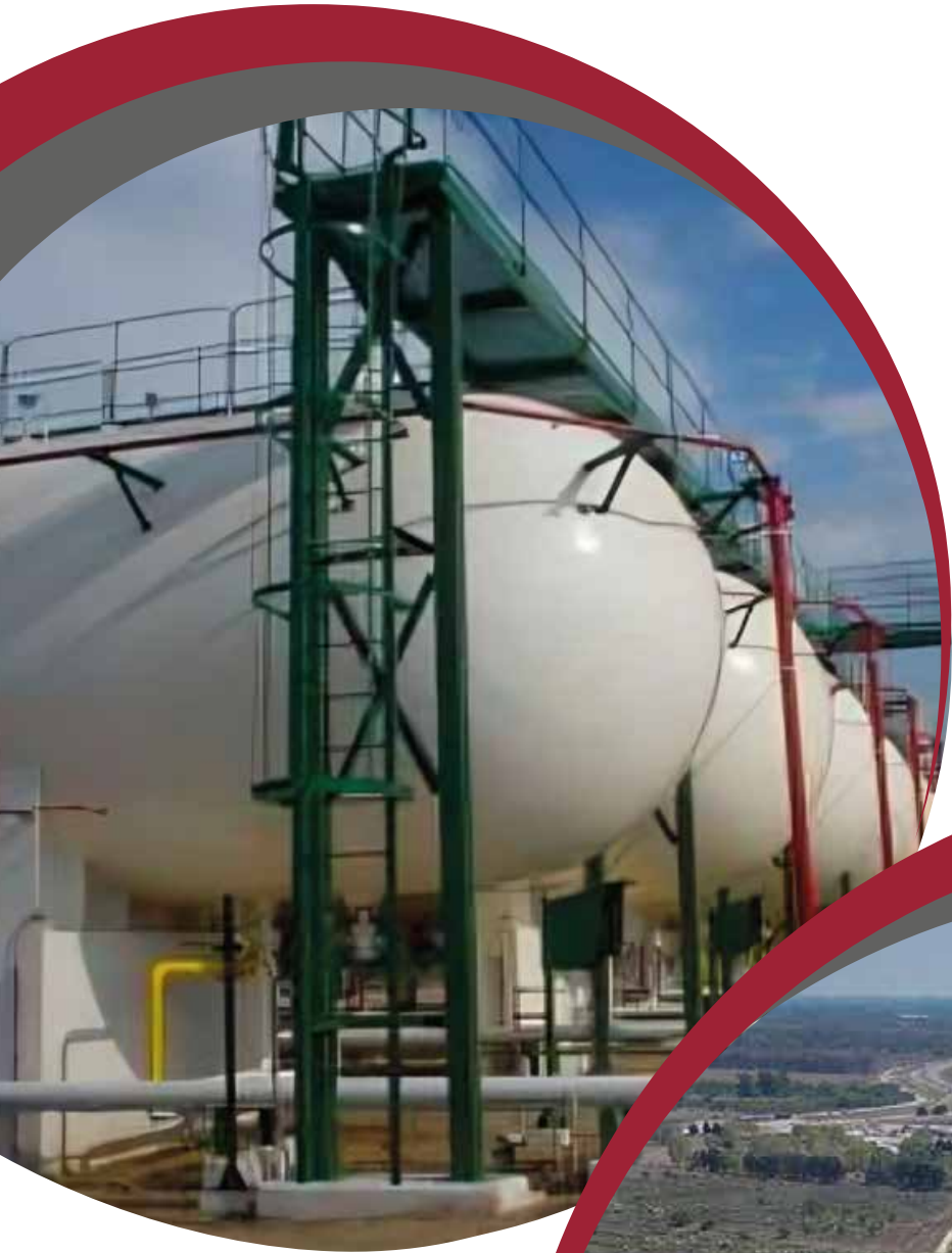
TANQUES Y OTROS MONTAJES ELECTROMECÁNICOS / TANKS AND OTHER ELECTROMECHANICAL ASSEMBLIES
